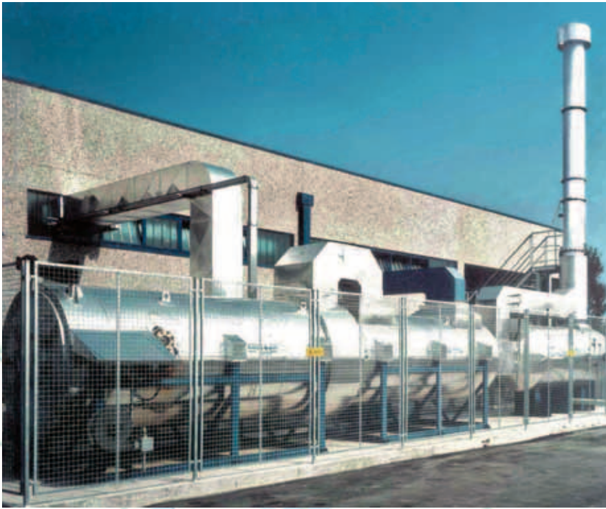
Stampa imballaggi flessibili Ricupero calore in olio diatermico • 18.000 Nm 3 /h
