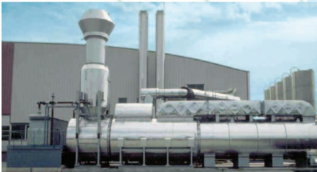
Stampa su alluminio Combustore con ricupero calore in olio diatermico • 45.000 Nm 3 /h
