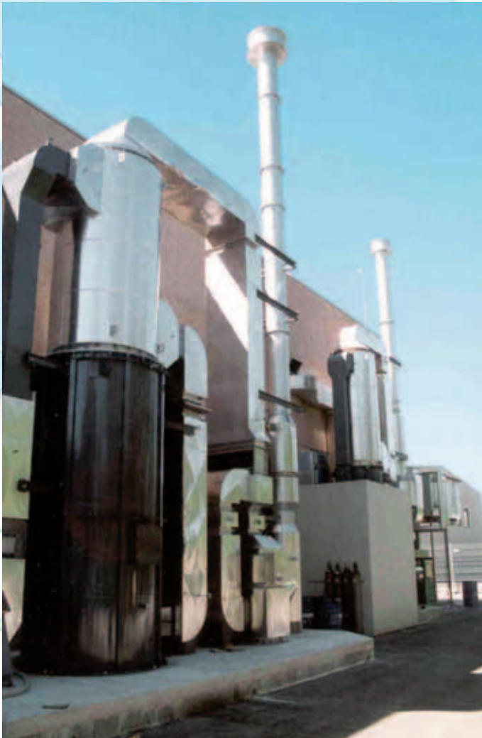
Industria farmaceutica • n. 2 combustori con ricupero calore in aria+acqua calda • 6.000 Nm 3 /h
