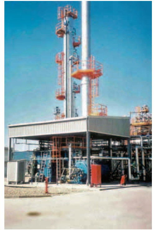
Industria petrolchimica Combustore monoblocco con ricupero calore in olio diatermico
